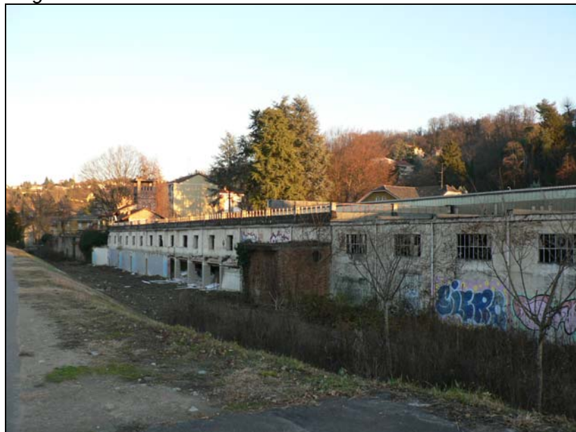
Figura 4.8/2 Il degrado del fronte lato fiume
